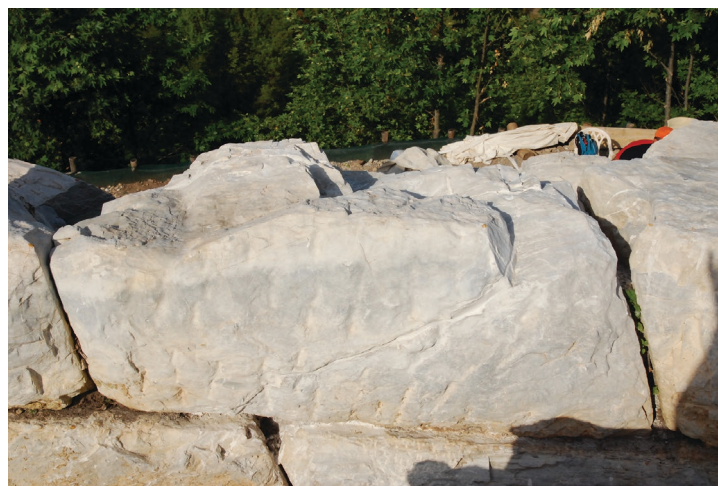
Ρηγματωμένος λιθόπλινθος της εσωτερικής παρειάς του πύργου, πριν και μετά τη συγκόλληση
