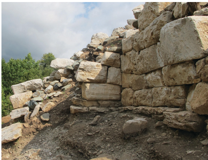
Η κατεστραμμένη ΝΔ γωνία του πύργου πριν τις εργασίες αποκατάστασης
